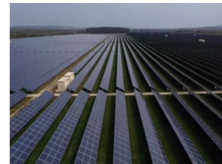
Photographie du parc photovoltaïque "Karad" - Bulgarie
